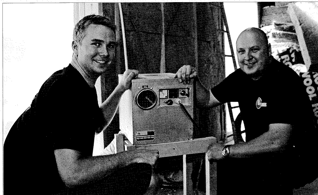
Rotoravfuktere er energibesparende og tar ikke opp mye plass. Både Christian Askildsen (t.v.) og Thomas Bakken er godt fornøyd med resultatet, tørt bygg uten fuktproblemer.
