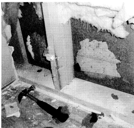
ENEBOLIG PÅ KARMØY: Isolasjonen har ligget helt inntil Asfaboard/betong. Pegasus Lab. AB fant høye konsentrasjoner av mikroorganismer, og analyseresultatet indikerer mikrobielle skader.
